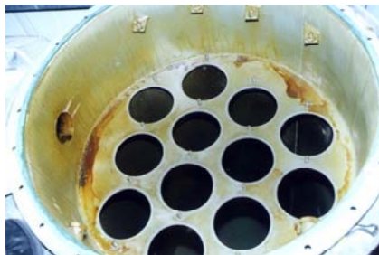
Teerablagerungen in einem Schlauchfilter (Reingasseite), Filterschläuche ausgebaut
